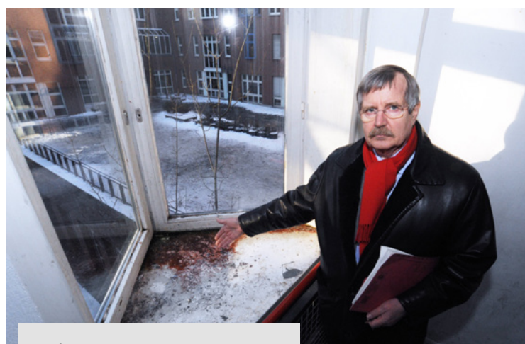
Auf diesem Bild zeigt Hartmut Blees, Leiter der Moses-Mendelsohn-Oberschule Berlin, die Schäden an einem Fenster seiner Schule.
